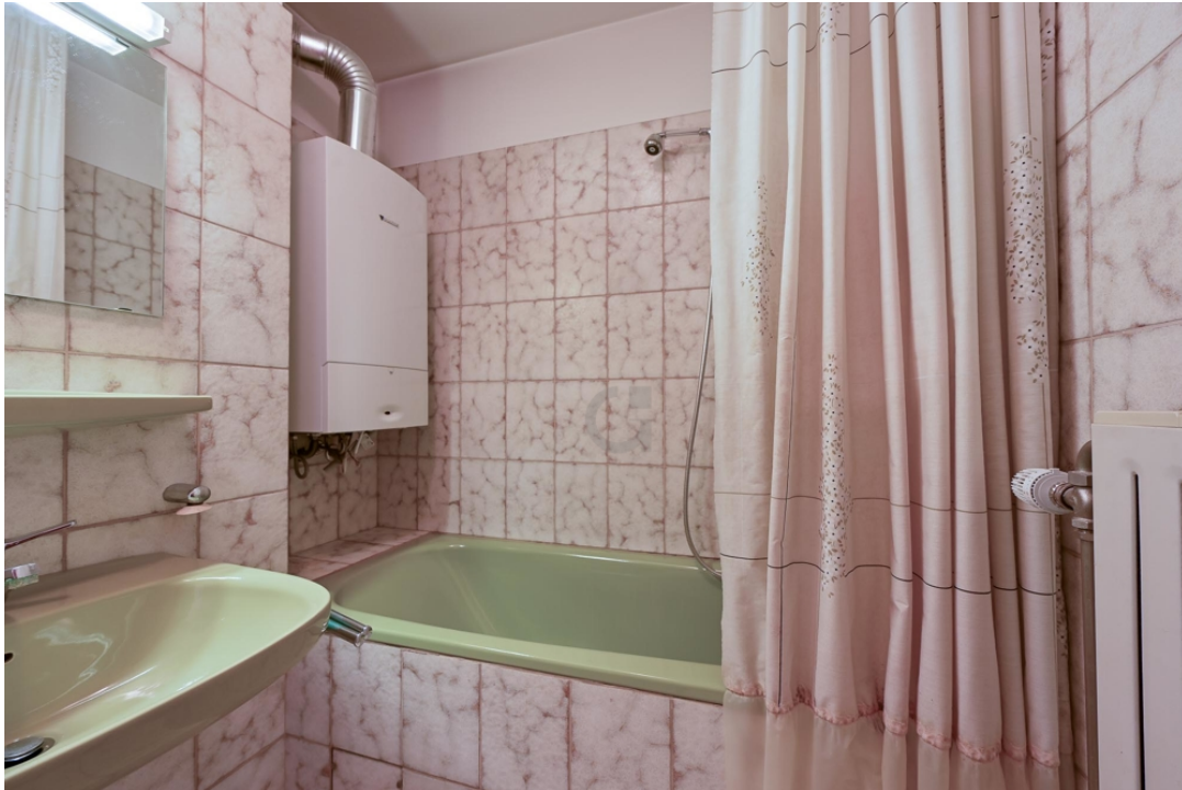
Bad mit GasEtagenHeizung
